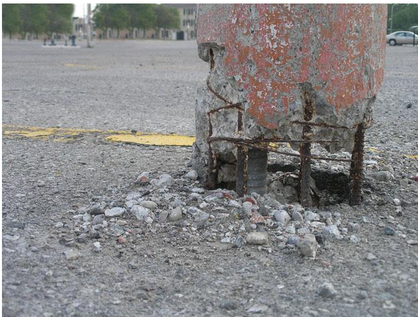
Balstu esošais tehniskais stāvoklis
